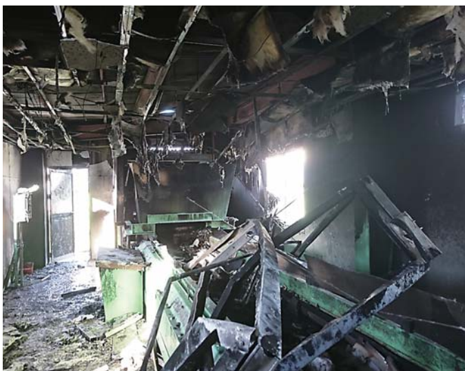
▲リチウムイオン電池の発火が原因で、リサイクル工場の建屋・設備が焼けてしまった事例
